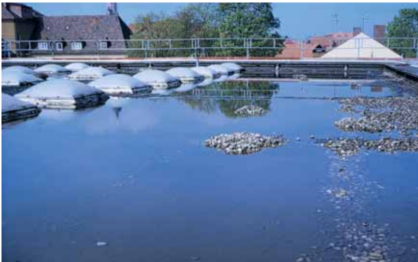
Stehendes Wasser auf einem Null-Grad-Dach
