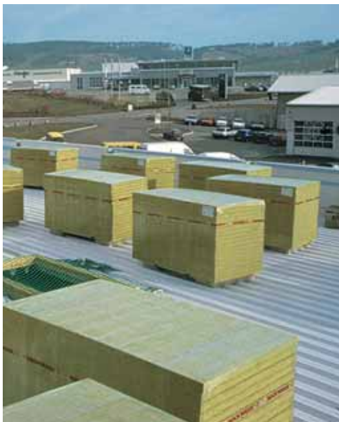
Hardrock GF im Großgebäude
